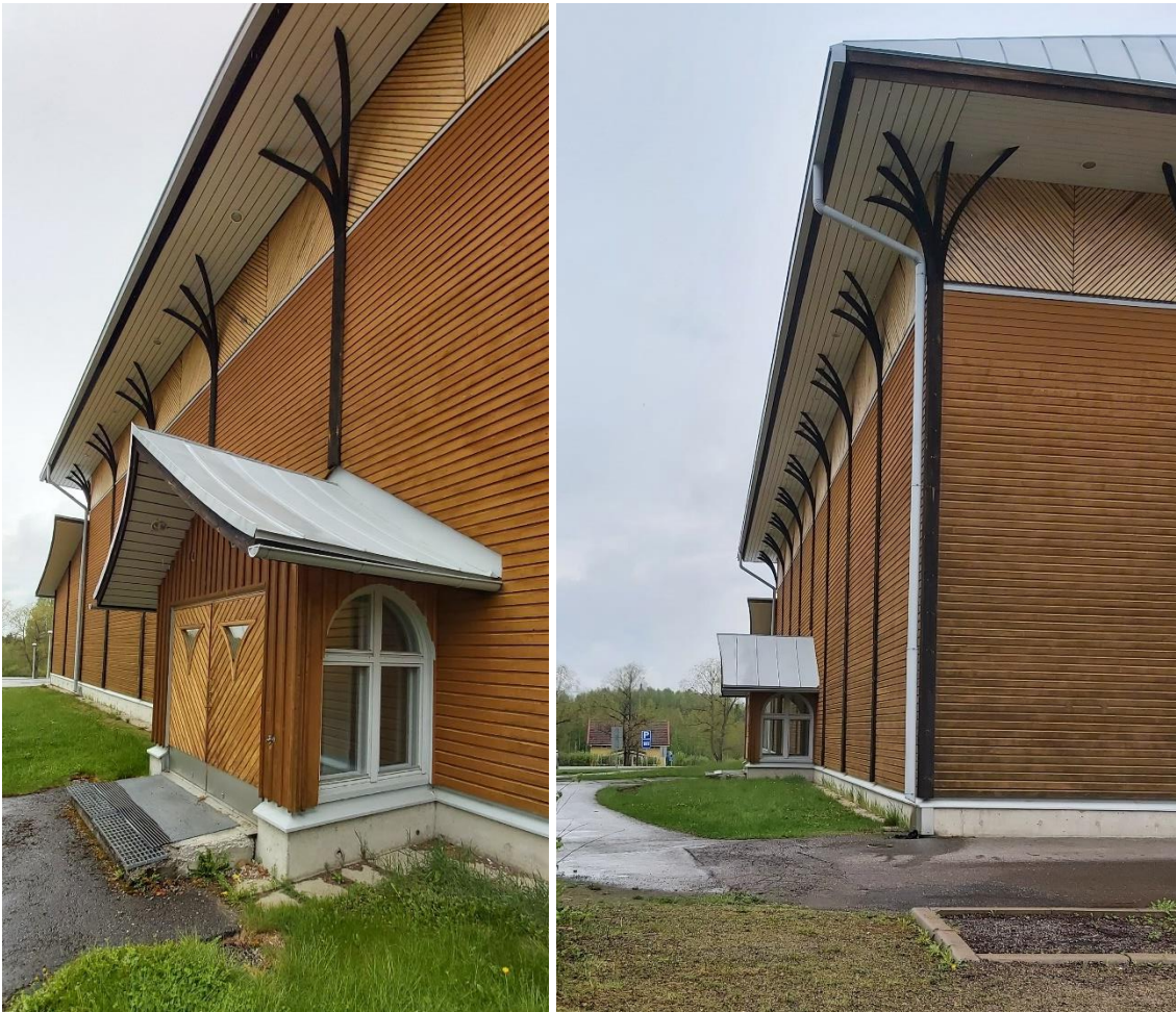
Kuvat 43 ja 44 Hauki-Hallin julkisivua etelään. Julkisivu on umpinainen ja sen keskivaiheilla on katettu sisäänkäynti.
